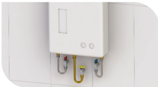
Válvula do aquecedor fechada
